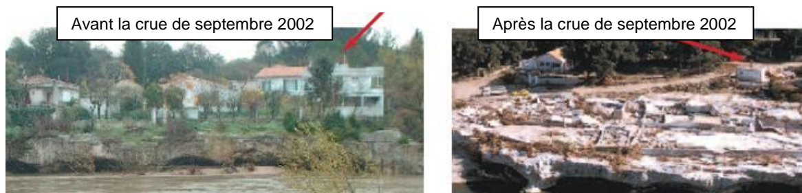
Figure 8 : Illustration des destructions observées au quartier Ron de Fabre lors de la crue de septembre 2002 (source : Mairie de Collias)
