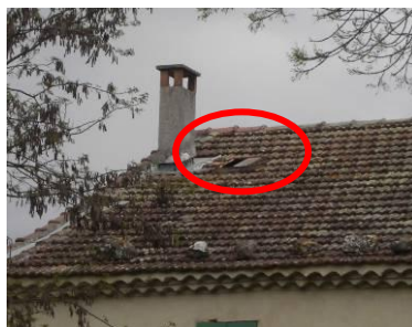
Figure 33 : Position d'une fenêtre dans la toiture (photo prise lors de la visite du 03 avril 2014, Safege)
