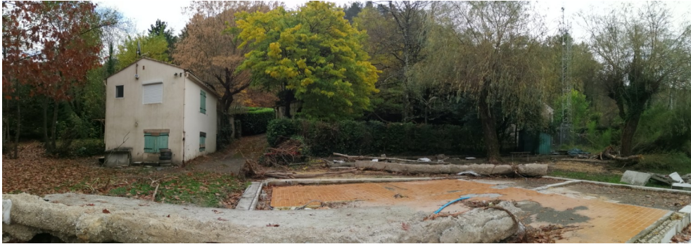
Photo 4 : vue depuis la berge (à l'Ouest) de la dalle restante suite à la crue
