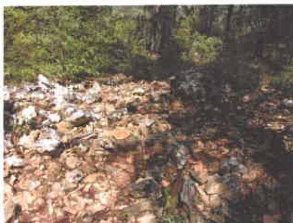
Ancien murêt effondré
