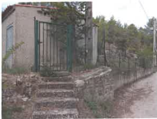
Captage de la source de la vieille église commune de BELVEZET
