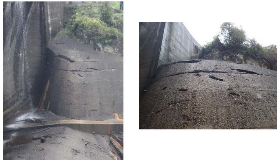
Figure 22 : Désordres sur le massif, rive gauche du barrage
