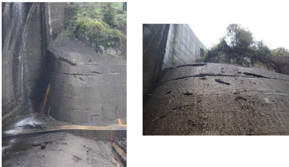
Figure 14 : Photos récentes des désordres sur le massif rive gauche [Réf 4]
