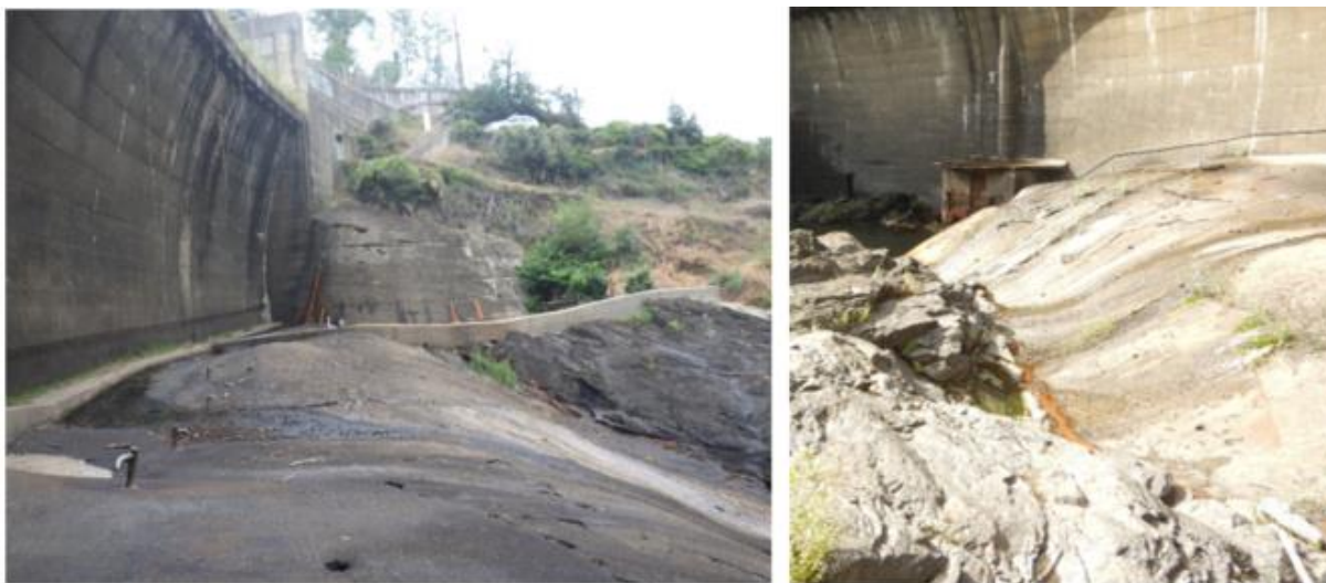
Figure 11 : Carapace en aval rive gauche de l'ouvrage
