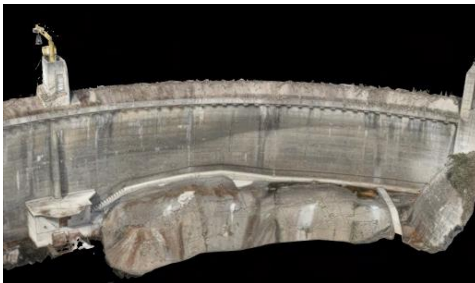
Figure 12 : Fosse aval rive gauche
