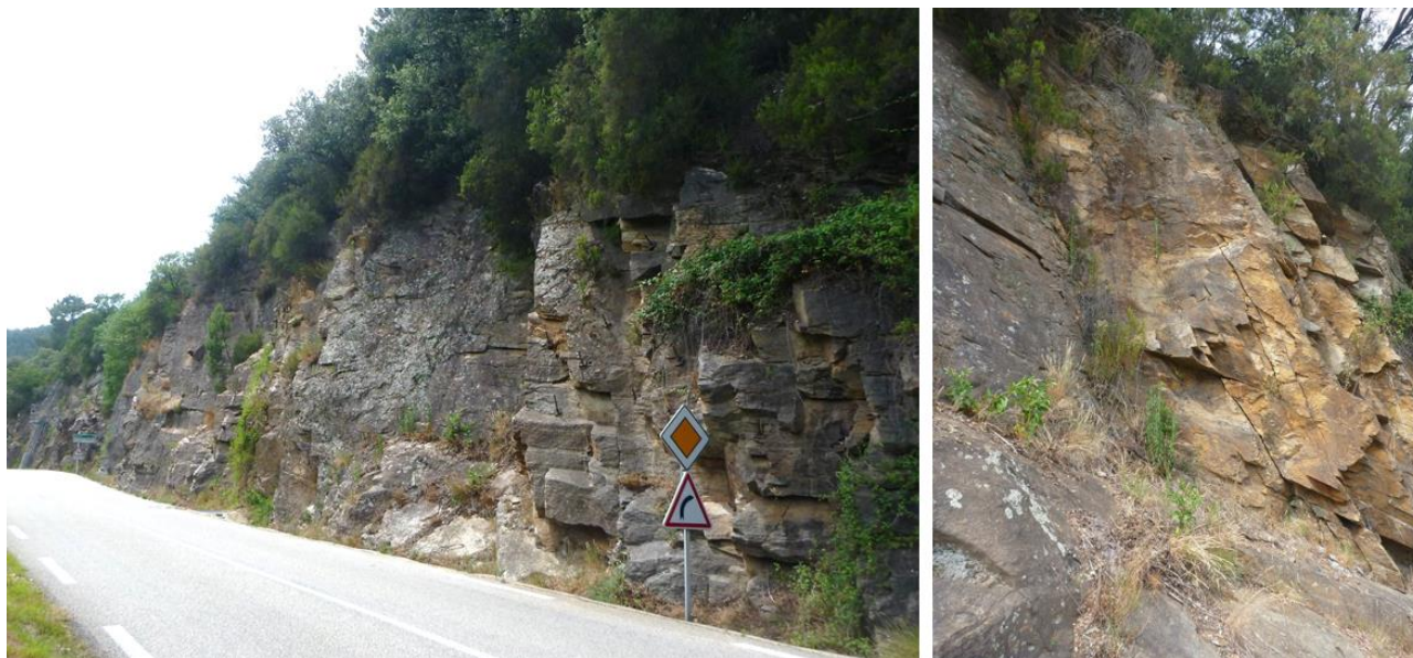
Figure 35 : Affleurements du versant rive gauche à l'aval du barrage le long de l'actuelle route nationale
